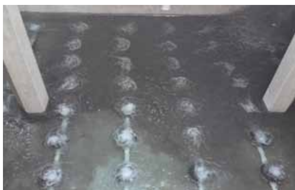
Fig. 4 - Nuovo sistema di diffusione aria in nitrificazione.
