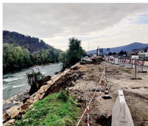
Il cantiere a Nembro sulla 671 dove hanno ceduto i tralicci
