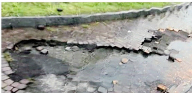
Il fondo ammalorato della «corona» del rondò di fronte a Villa Mapelli
