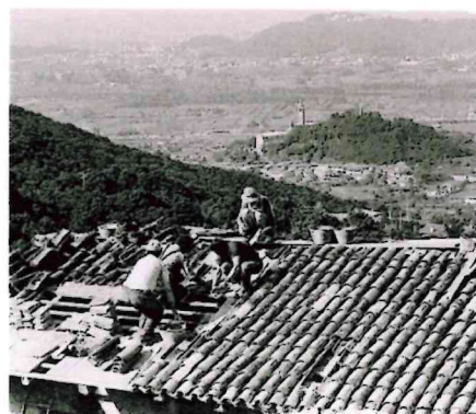
Gli alpini bergamaschi al lavoro sul tetto di una casa a Gemona
