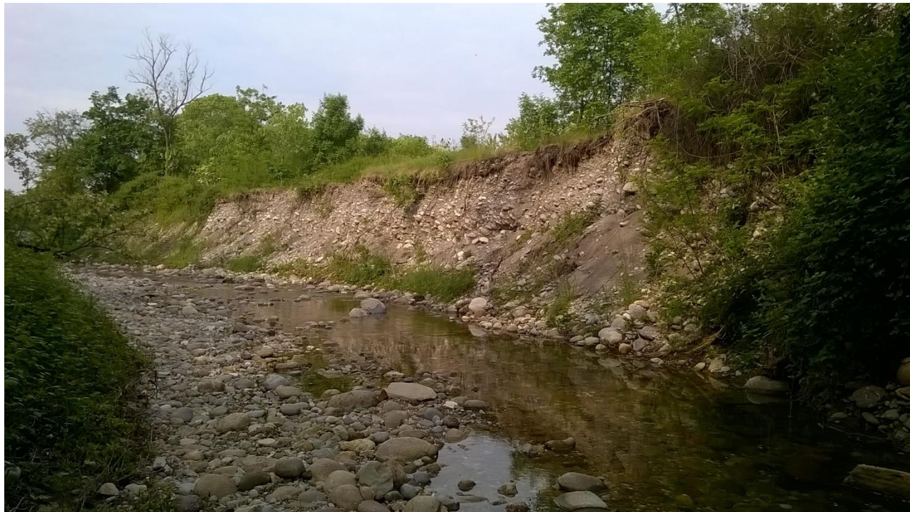
Vista del tratto di sponda destra in erosione lungo un tratto dove al ciglio della scarpata alta circa 3 m transita il sentiero in parte crollato.
