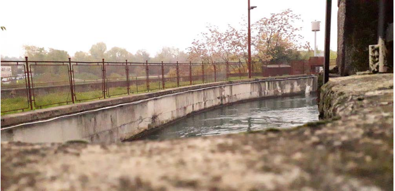
Canale ENEL Green Power in via Rattini
